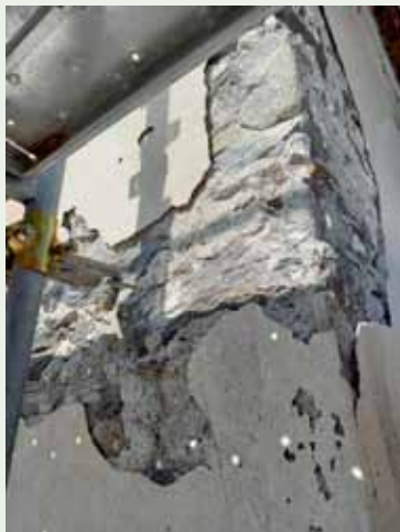
Degrado per polverizzazione dell'intonaco di fondo Rifacimento su parte dei quadranti degli orologi
